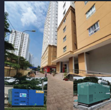
KHU CĂN HỘ CAO TẦNG IDICO – TP HCM 1 x MPĐ 500kVA – DOOSAN (Hàn Quốc) 1 x MPĐ 300kVA – CUMMINS (India)
